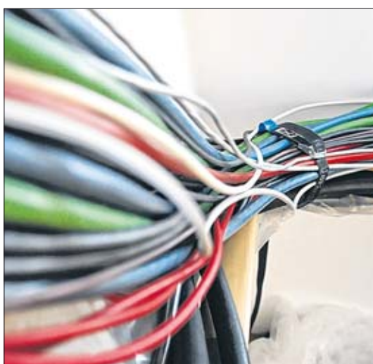
Dicke Kabelbündel sind nötig, um das Landeshaus für die Journalisten mit der Außenwelt zu verbinden.
